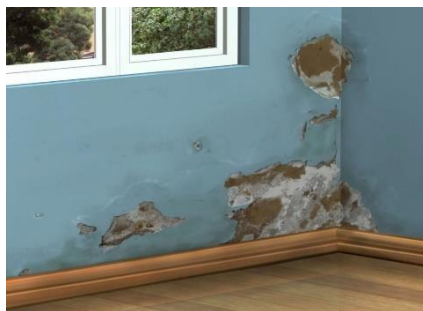
Ilustración 9: pared con problemas de humedad en el interior de vivienda.
